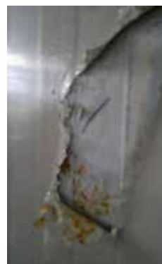
Beispiel von Oxidierung nach Blistering
